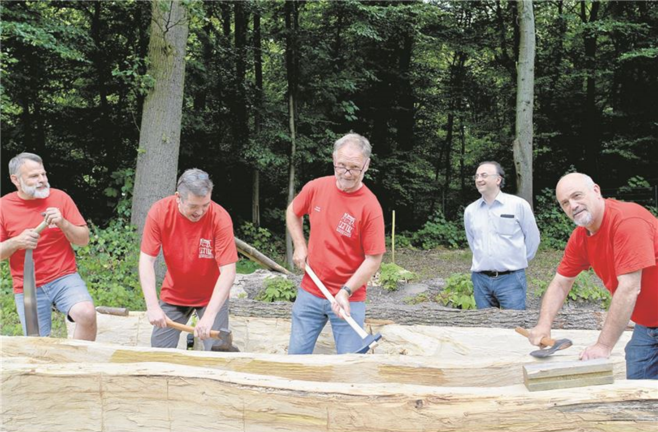
Am Wochenende griffen Jörg Steinhauer, Harold Pieters, Hans Koehn und Wolfgang Steinhauer (v.l.) zum Werkzeug, um die Erweiterung der Holz-Erde-Mauer im Römerpark Oberaden zu unterstützen. Foto: Sarad
